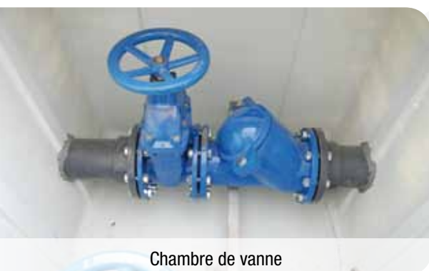
Raccordement d'une cuve
