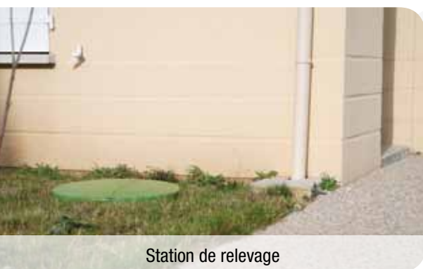
Poste de relevage Domalin 3
